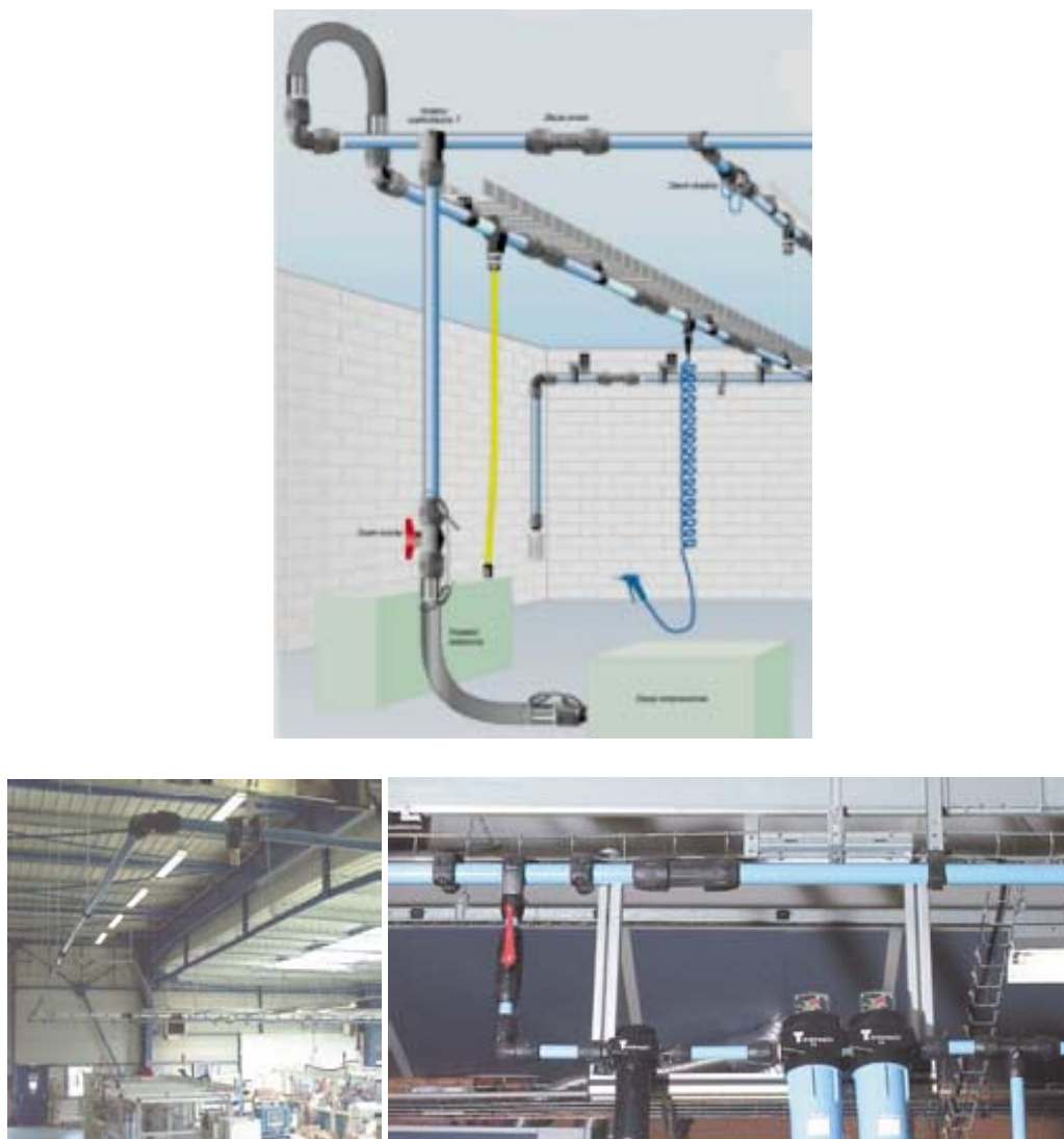
Rys. 4.3.5. Przykład instalacji sprężonego powietrza [52]
