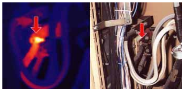
Rys. 4.32. Termogram i zdjęcie fotograficzne instalacji elektrycznej. Kolor żółty wskazuje wadliwy element
