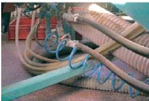
Rys. 4.5.6. Nieszczelności pojawiają się często na przyłączach elastycznych[3]
